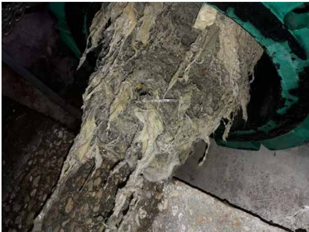
Les lingettes se gonflent de matières et bouchent les canalisations (©Siarce)
