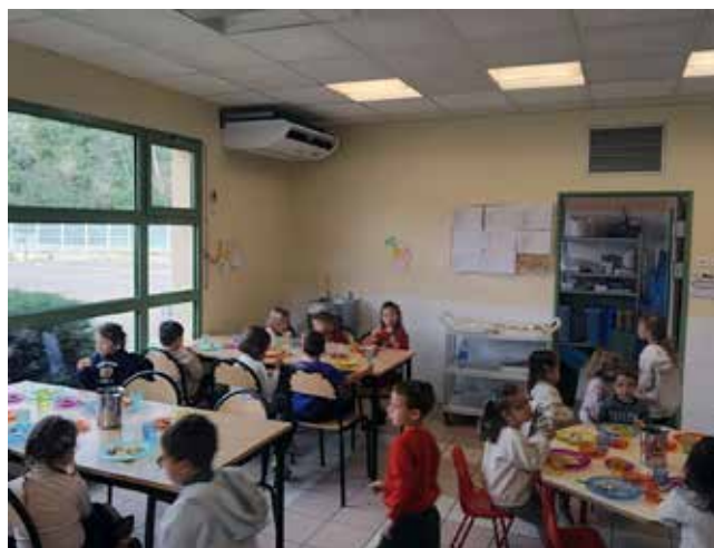
Climatisation de la cantine scolaire
